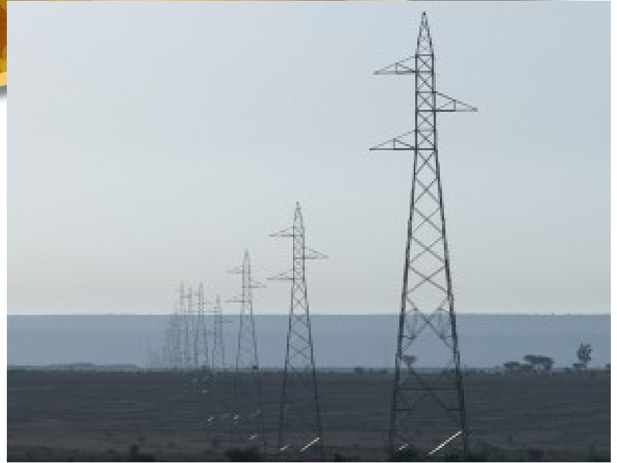
የጅግጅጋ ደገሀቡር የሃይል ማስተላለፊያ መስመር
