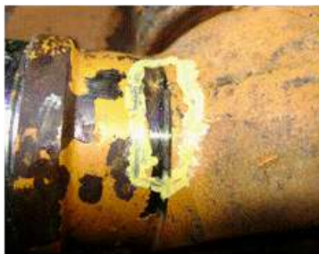
Componente a simple vista, donde no se observan discontinuidades aparentes
