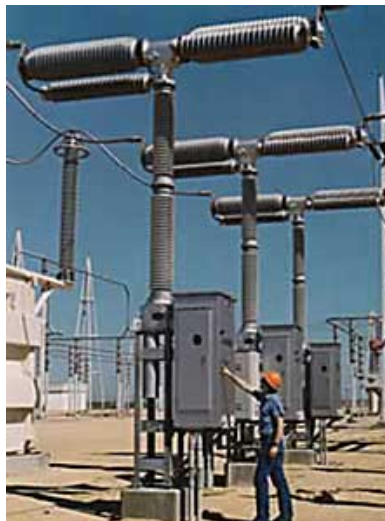
Figura 4.23 Disjuntor a Gás SF 6 .
