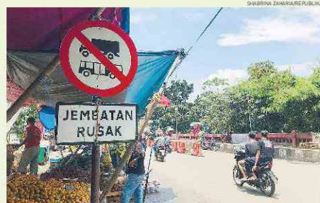
● Tiang di jembatan Jalan MA Salmun, Kelurahan Cibogor, Kecamatan Bogor Tengah, Kota Bogor rusak sejak 2020 dan tengah menanti perbaikan.
