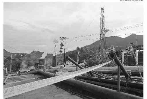
KECELAKAAN KERJA Garis polisi dipasang di lokasi kecelakaan kerja di PAD 28 PT Geodipa Energi di Desa Pawuhan, kawasan dataran tinggi Dieng, Batur, Banjarnegara, Jawa Tengah, Ahad (13/3). Kecelakaan kerja di PLTP pembangkit listrik tenaga panas bumi Dieng menyebabkan satu orang meninggal dan delapan orang dirawat diduga terkena gas beracun H 2 S.
