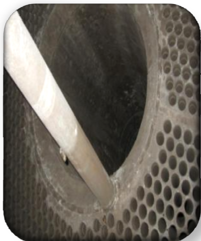
Figura No. 2 Arreglo de tubos, en el interior del evaporador de calandria
