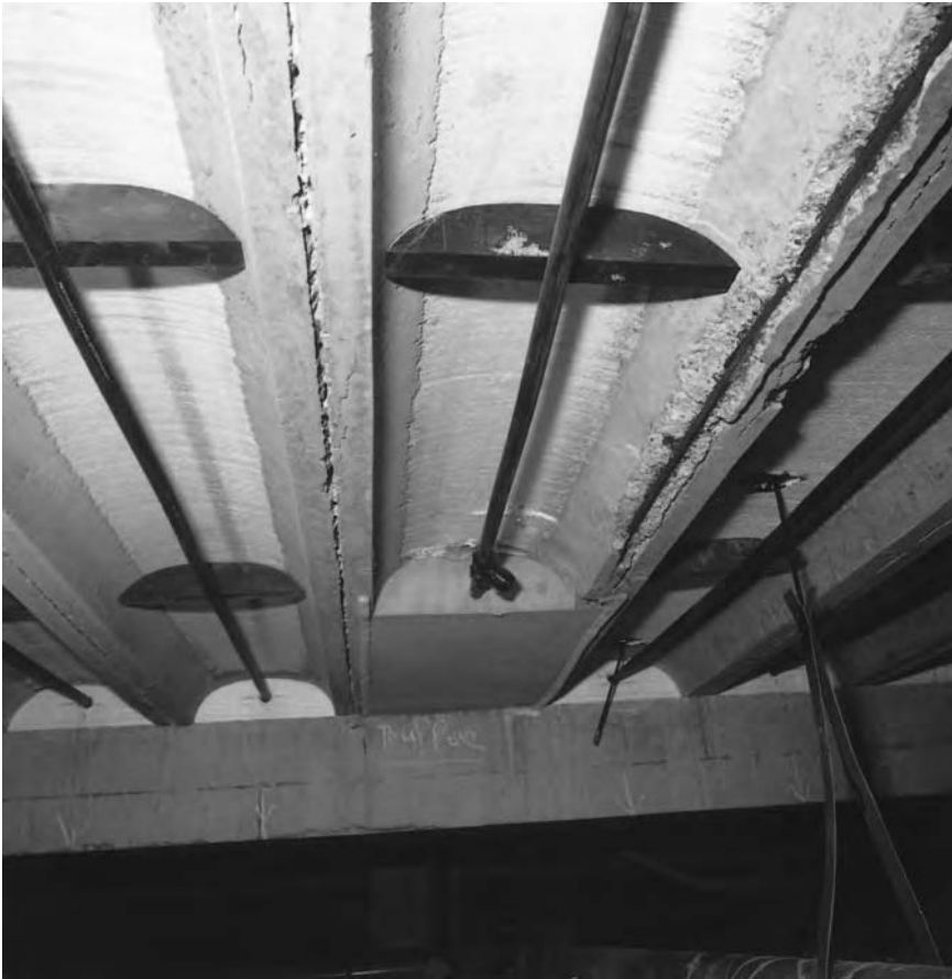
7.5 Prestressing tendons underneath Kwaaitaal floor.
